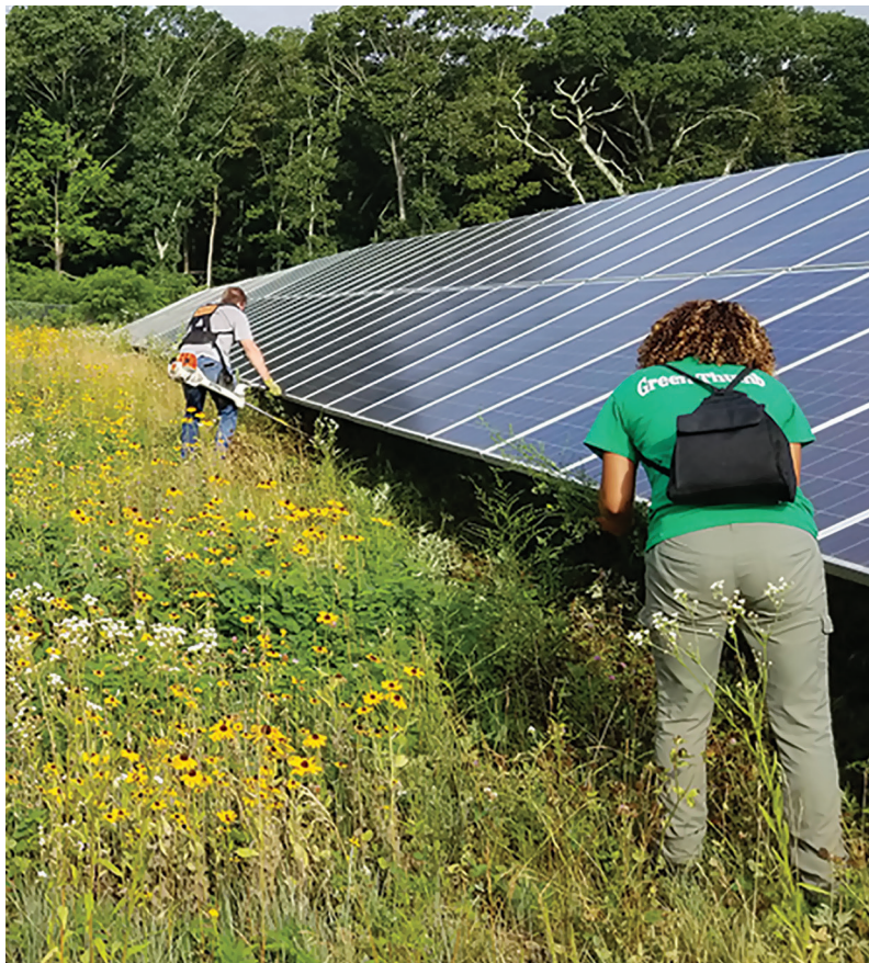
Una equipo de trabajadores lleva a cabo el control de los polinizadores y el mantenimiento de la vegetación en el panel solar de 1 MW instalado por las Hermanas de San José en su campus de Brentwood, Nueva York. © Rusty Schmidt
