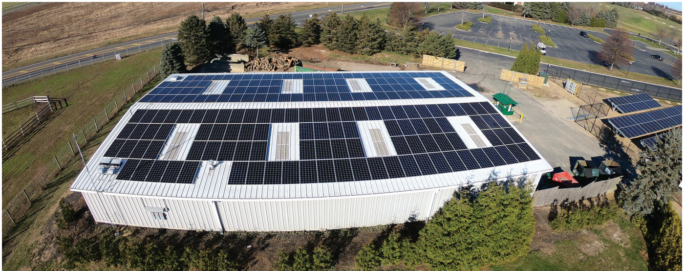
Paneles solares montados en la azotea y en el suelo en el campo de golf Long Island National Golf Club en Riverhead © SUNation Solar Systems
